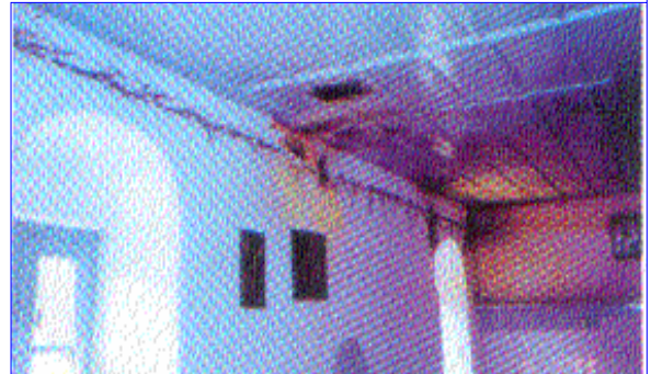
Καταστροφή ηλεκτρικής εγκατάστασης από κρουστικές υπερτάσεις από πτώση κεραυνού.
